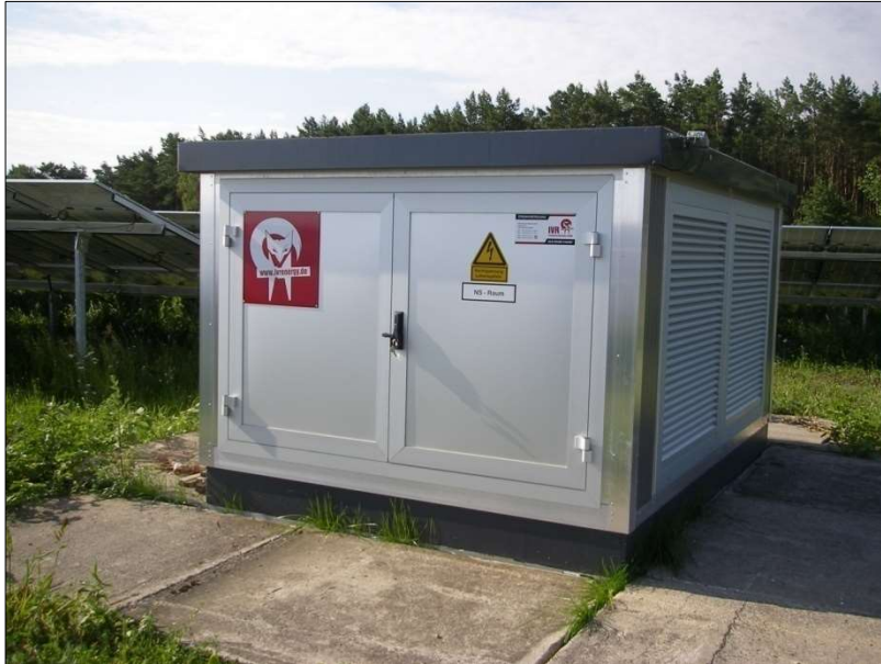
Abb. 23: Beispiel für einen Transformator, der den Wechselstrom von 400 V auf 20 KV hochtransformiert (hier PVA „Alte Poststraße“ Friesack, Zootzen). (Foto RIK: P1010052_2023-07-13)
