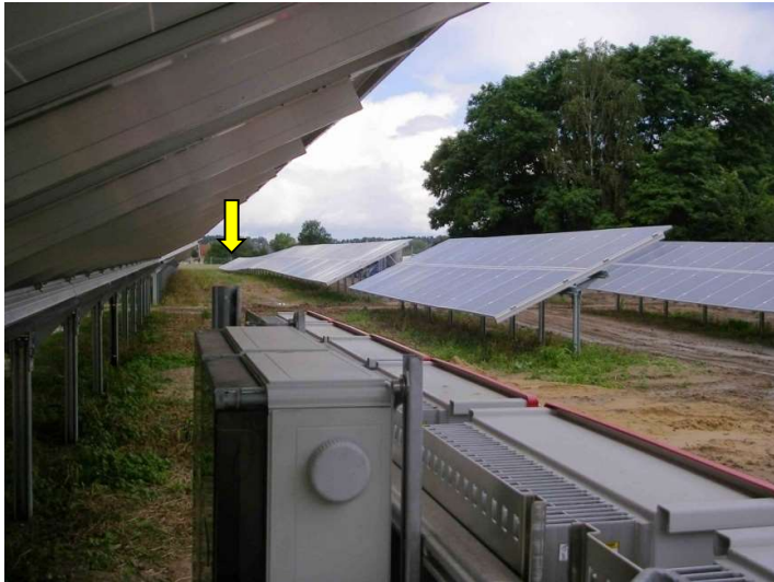
Abb. 27: Beispiel aus dem Solarpark Kremmen für die höhenmäßige Anpassung der Modulreihen an das Gelände. Der Pfeil zeigt eine Verwerfung, die für die Funktionstüchtigkeit der Photovoltaikmodule ohne Bedeutung ist. (Foto RIK: P7120009.JPG)
