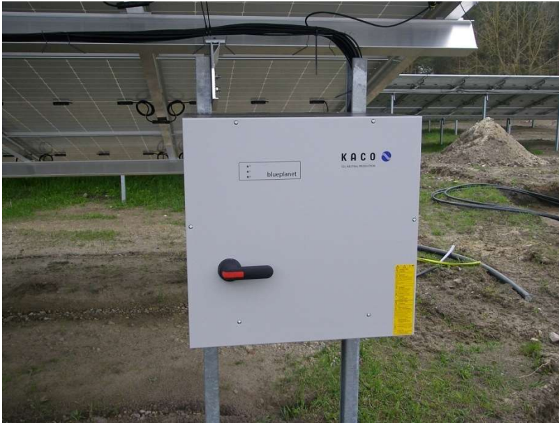
Abb. 22: Beispiel für einen unter den Modultischen stehenden Stringwechselrichter (hier PVA „Alte Poststraße“ Friesack, Zootzen). (Foto RIK: P1010014_2023-04-18)
