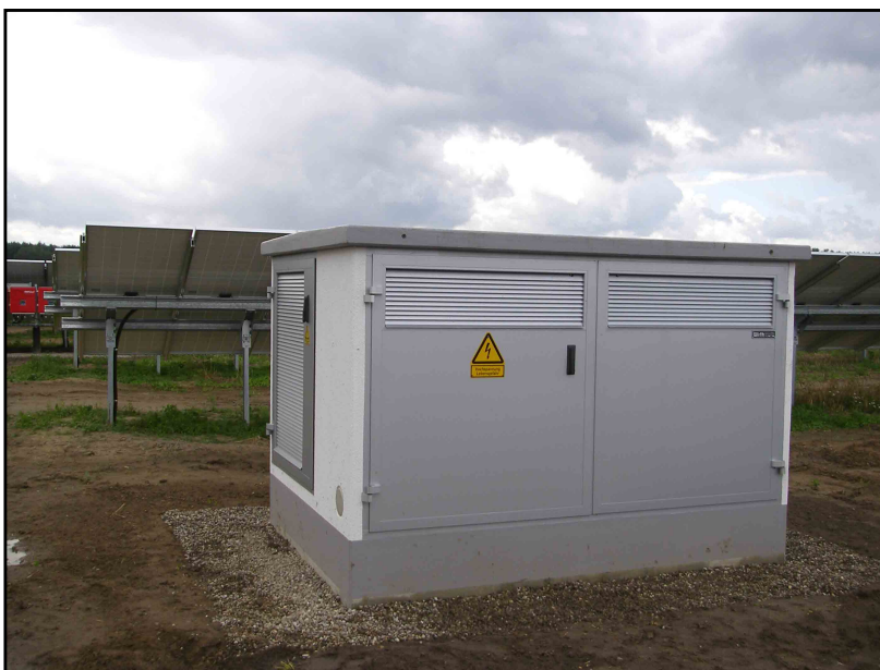
Abb. 18: Beispiel für einen Transformator, der den Wechselstrom von 400 V auf 20 KV hochtransformiert, hier Solarpark Kremmen. (Foto RIK: P7120014.JPG)
