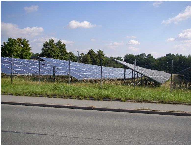
Abb. 14: Beispiel für Modulreihen einer Freiflächen-Photovoltaik-Anlage (hier Solarpark Bautzen) wie sie für die PV-Anlage an der Alten Poststraße zum Einsatz kommen soll. (Foto RIK: P1010002)
