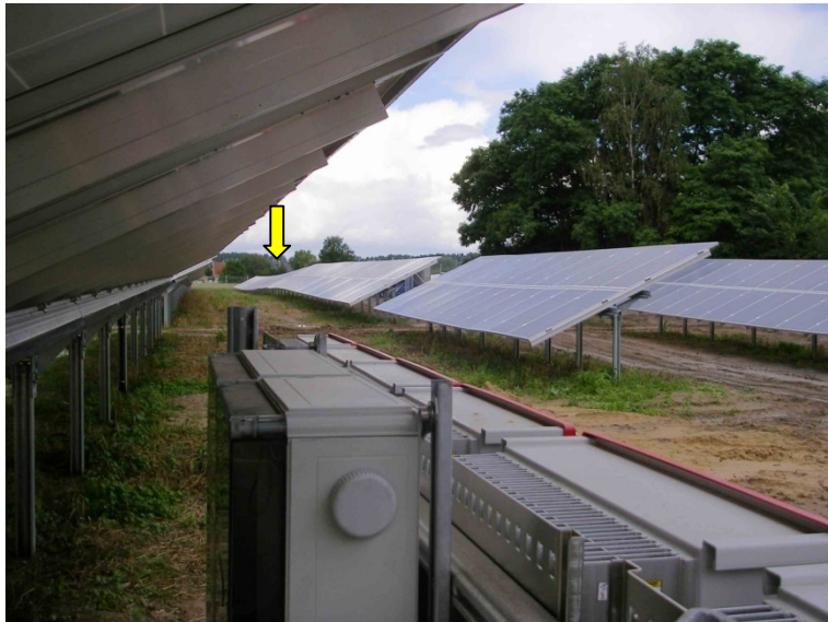
Abb. 20: Beispiel aus dem Solarpark Kremmen für die höhenmäßige Anpassung der Modulreihen an das Gelände. Der Pfeil zeigt eine Verwerfung, die für die Funktionstüchtigkeit der Photovoltaikmodule ohne Bedeutung ist. (Foto RIK: P7120009.JPG)
